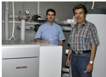
Manfred Vilshöver (rechts) mit Ralf Breuer, Fachmann von STIEBEL ELTRON, in einem der Technikräume mit der Großwärmepumpe WPF 27.
