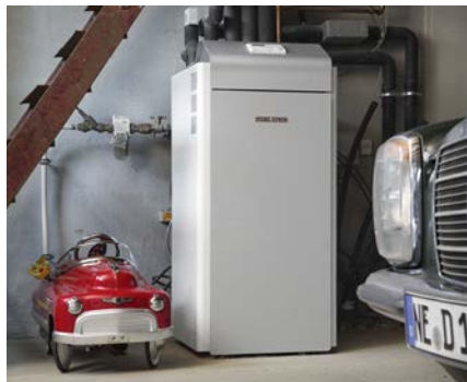
Die Wärmepumpe WPF 10 E in der Garage neben der großen Leidenschaft von Arndt Brauckmann – einem Mercedes-Oldtimer. Für den Nachwuchs links ein Gefährt eine Nummer kleiner.
