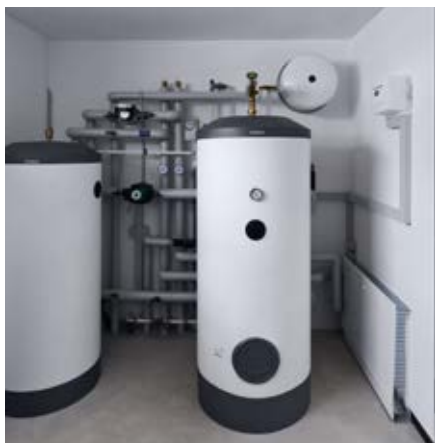
Im Technikraum sind ein Pufferspeicher und ein 300-Liter-Warmwasser-Standspeicher installiert. Alle Rohrleitungen sind perfekt isoliert, so dass keine Energie verloren gehen kann.
