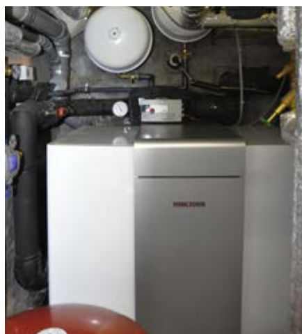
Wenig Platz, bestens ausgenutzt: die Wärmepumpe im Kellerraum.
